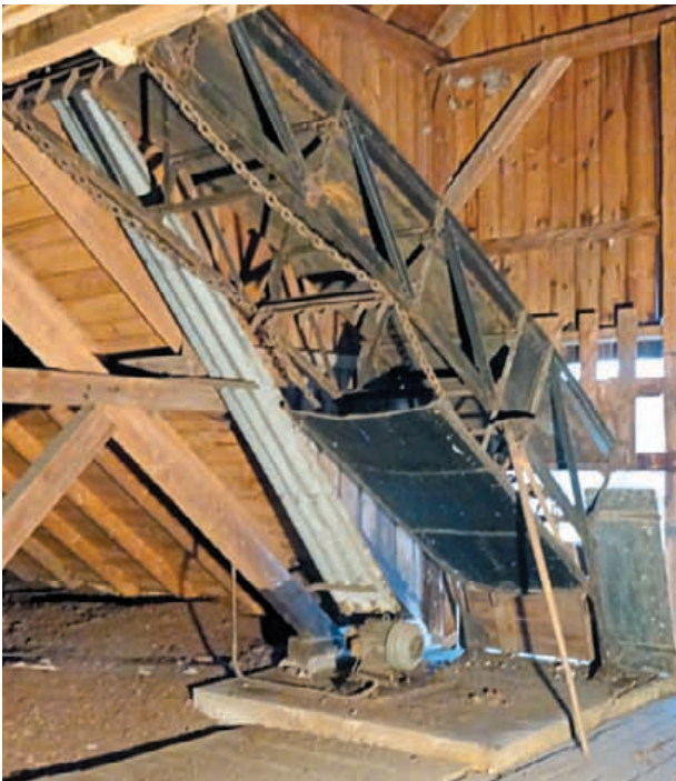
Das Ende des Eiselevators vor den Verteilrampen.
